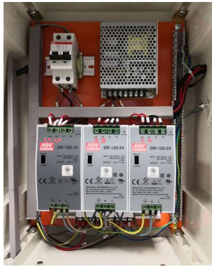
ก) ระบบจ่ายไฟ
